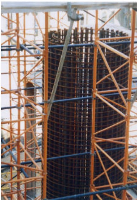
Visión de la alta densidad de armado de las columnas del crucero del templo.
