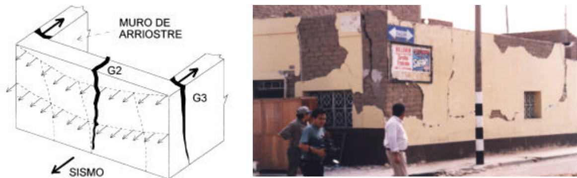
Figura 2. Fallas típicas en viviendas de adobe por acción sísmica perpendicular al plano de los muros: desgarramiento vertical en las esquinas y grieta vertical por flexión en la zona central del muro.
