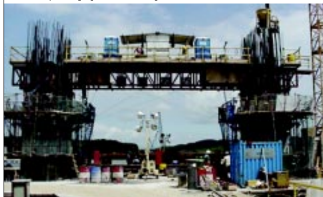
Foto 3: Punto central de control del equipo hidráulico.
